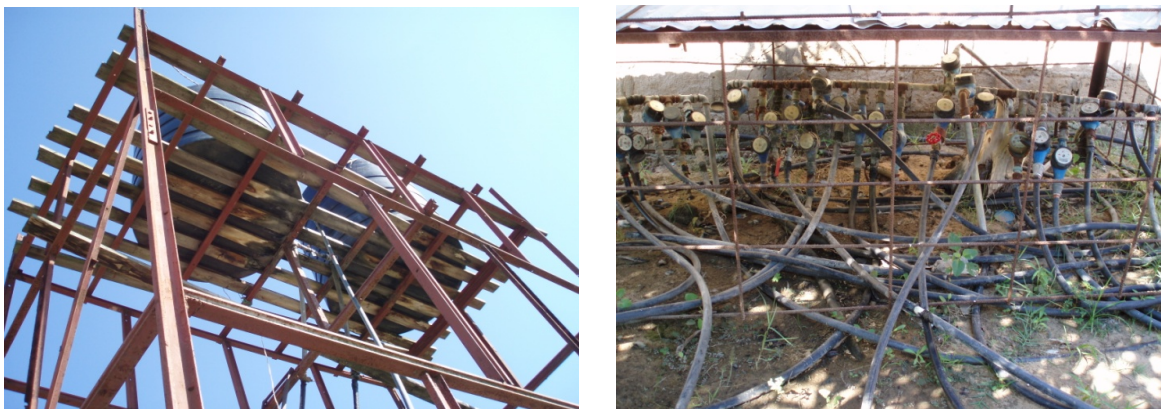
Figura 5.4 Reservatório de armazenamento de água de POP em Maputo (esquerda) e contadores do mesmo operador (direita).
